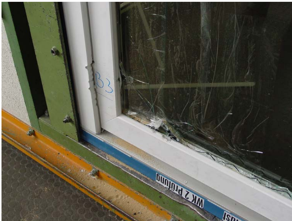
Bild 4 Schäden aus der manuellen Prüfung der Bandseite
