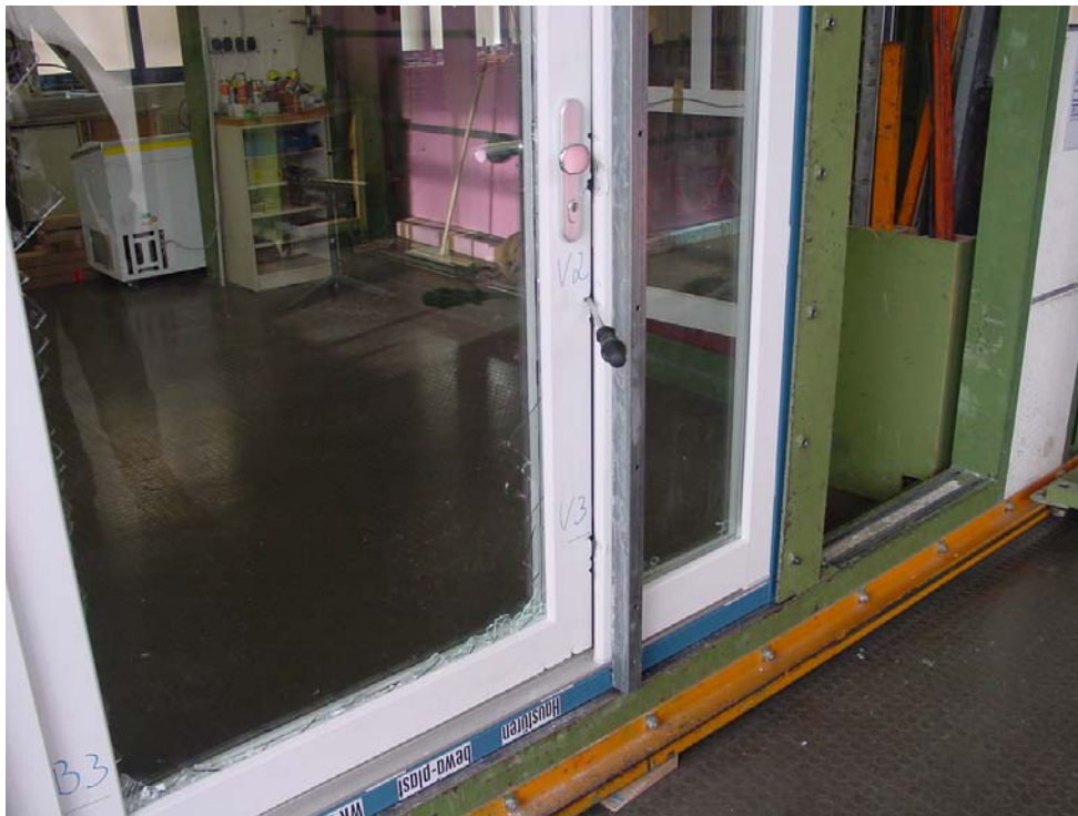
Bild 5 Schäden aus der manuellen Prüfung auf der Schlossseite
